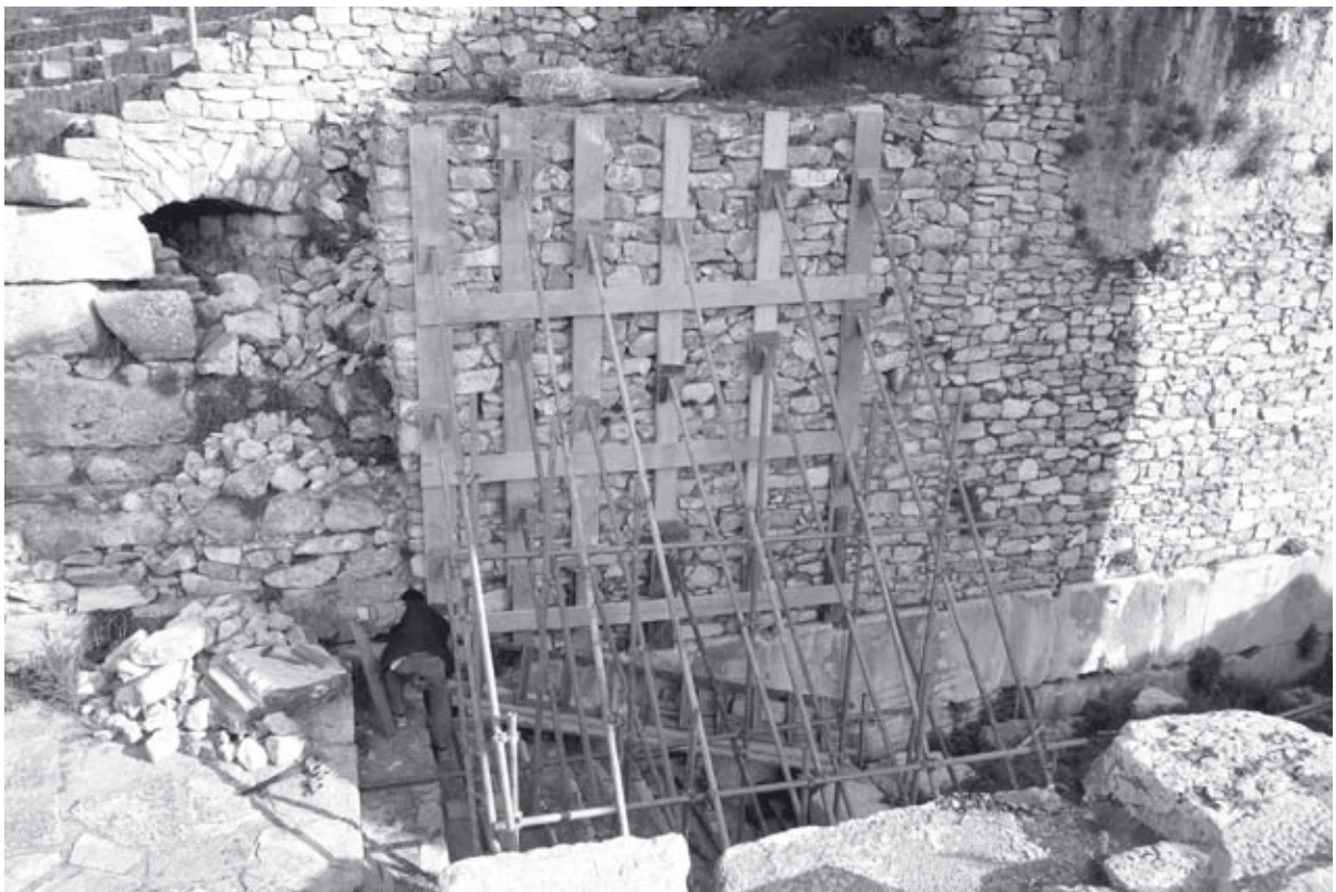
Abb. 313: ES1, Sicherungen an der O-Wand
