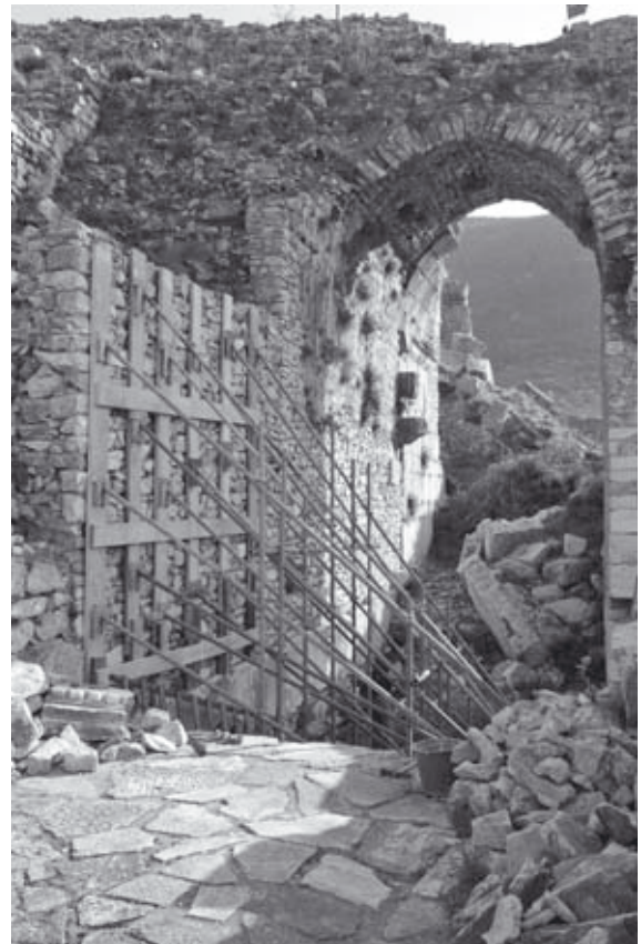
Abb. 312: ES1, Sicherungen an der O-Wand
